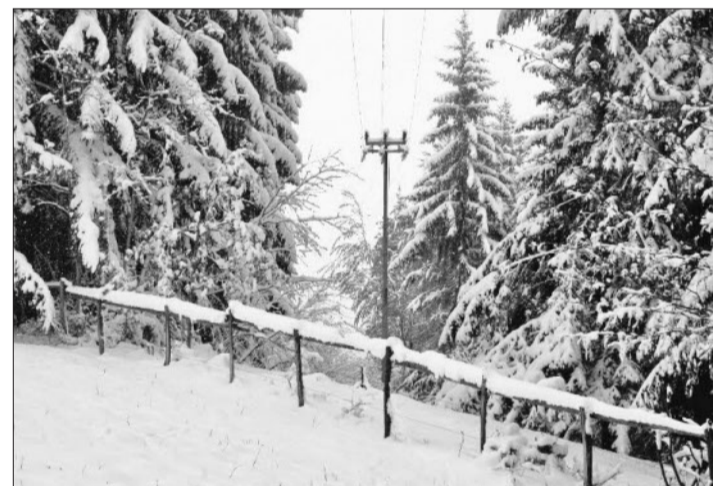
Die Oberradeiner Stromleitung führt durch den Wald. Der nasse Neuschnee drückte auf die Äste, die die Leitung beschädigten.
